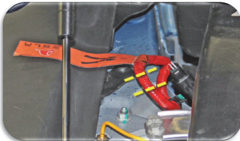
Фиг. 7. Външен вид на червените кабели проводници на ток.
