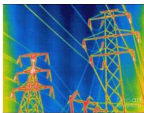
Термовизионна снимка на далекопровод
