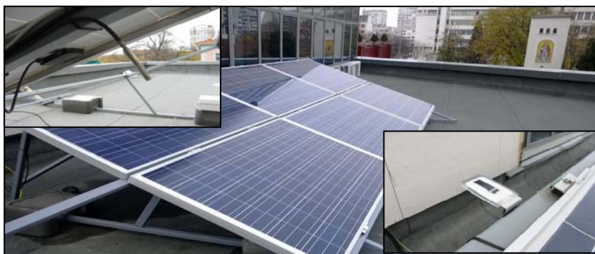
Фиг. 1. Фотоволтаична централа на покрива на БСУ
