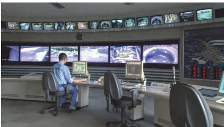
Фиг. 14. Център за контрол на отводнителната система
